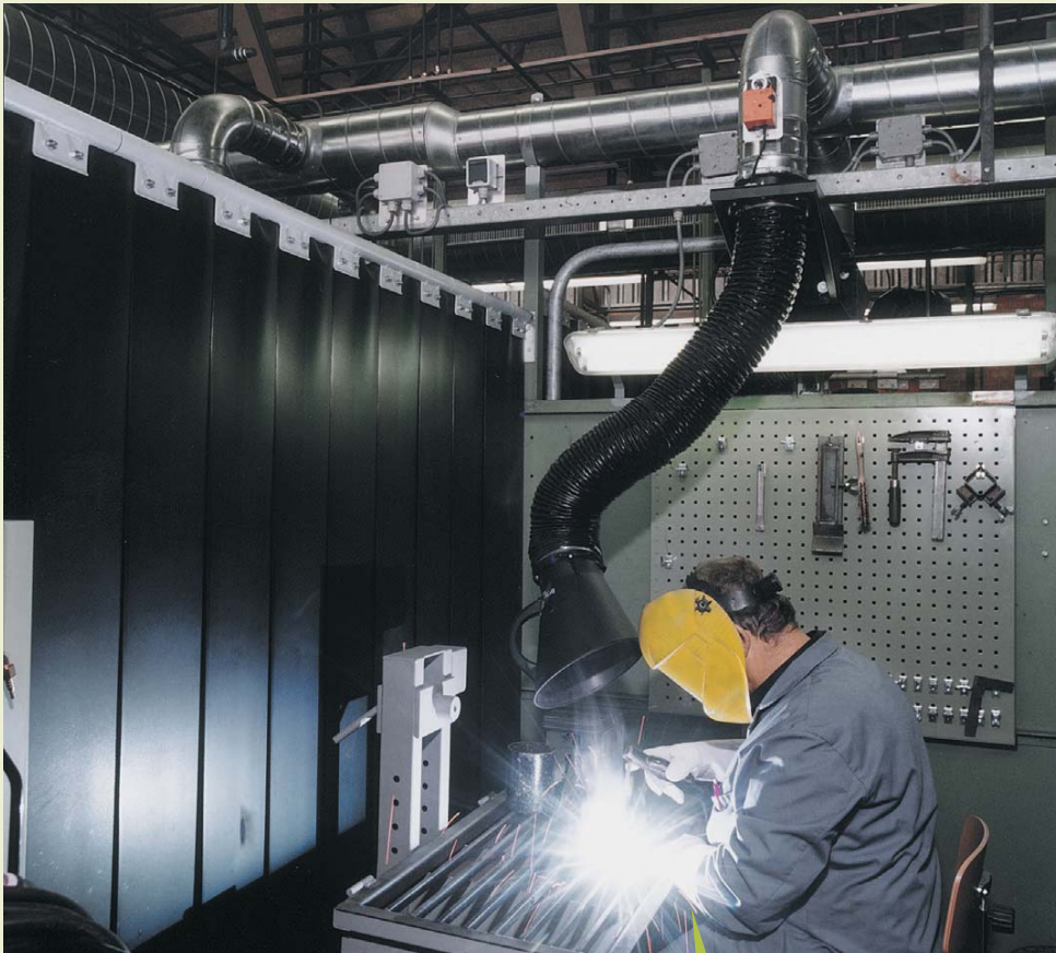
Anwendungsbeispiel: Teleskop-Absaugarm in Schweißkabine
